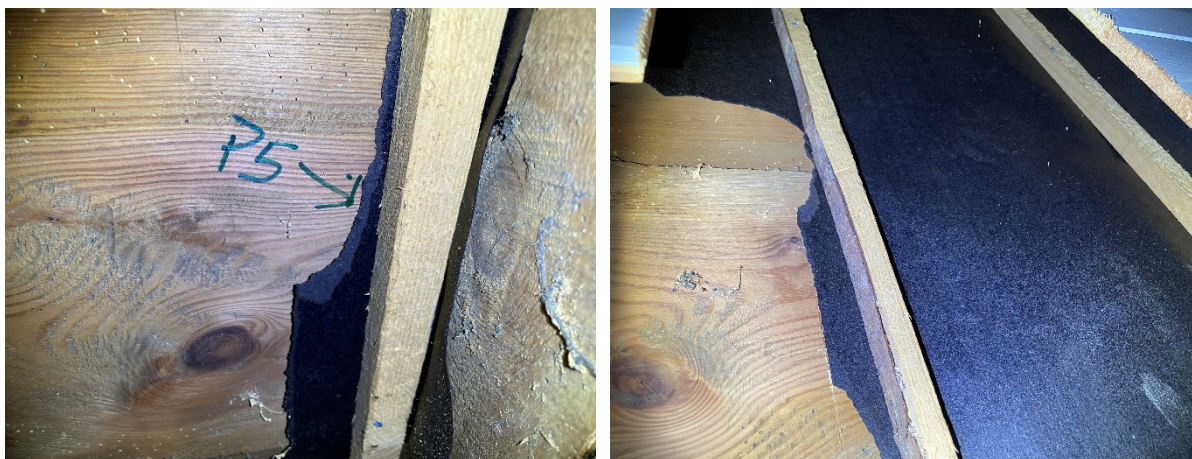
Figur 16: Det er ikke påvist asbest i takpapp
