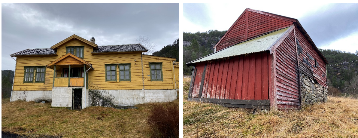
Figur 14: Gul og rød maling på fasadepanel er farlig avfall
