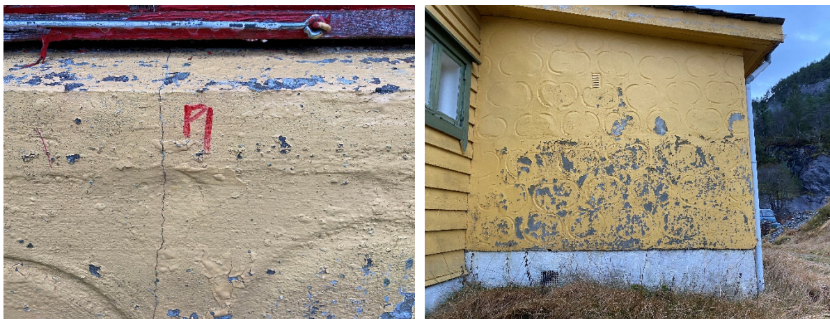
Figur 11: Maling på mur er lett forurensset avfall
