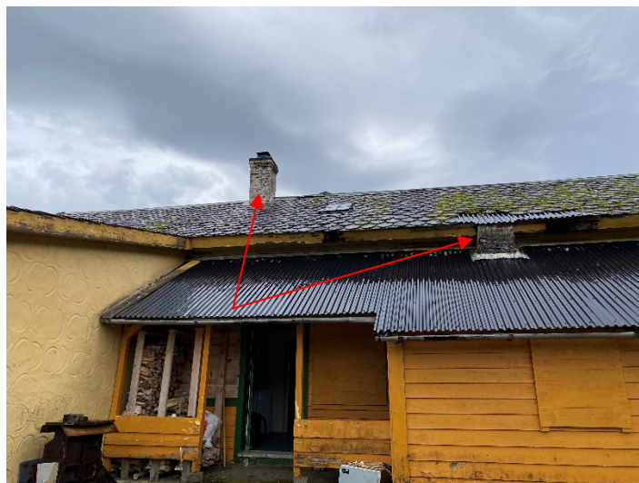
Figur 10: Pipestein med sot leveres som ordinært forurenset avfall
