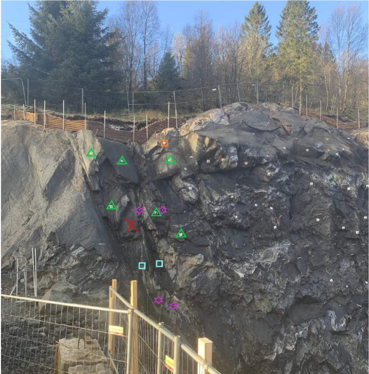
Figur 5-2: Utført sikring. Rødt kryss viser manglende bolt.
