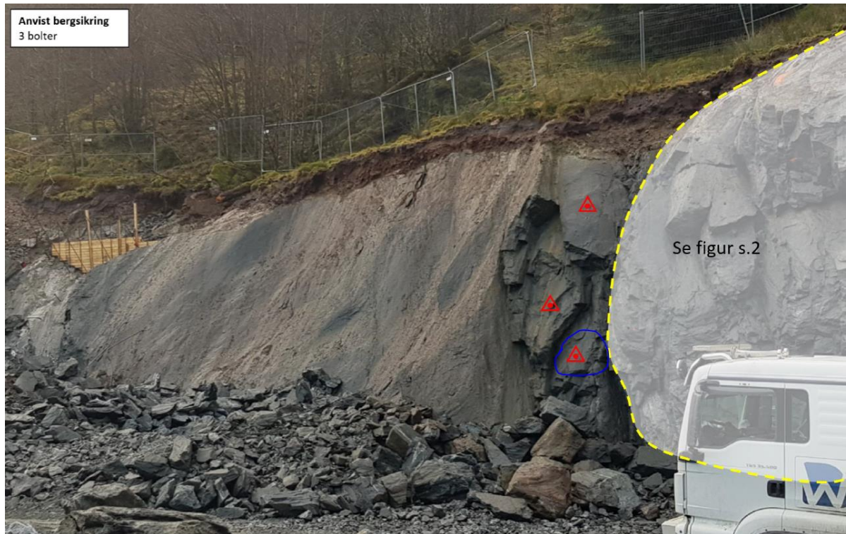
Figur 5-1: Anvist sikring i N_INGGEO-03, datert 20.12.2019. Blå sirkel viser anvist bolt som ikke er utført.
