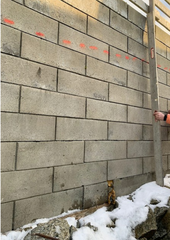
Muren som tydelig heller utover mot vårt hus.
