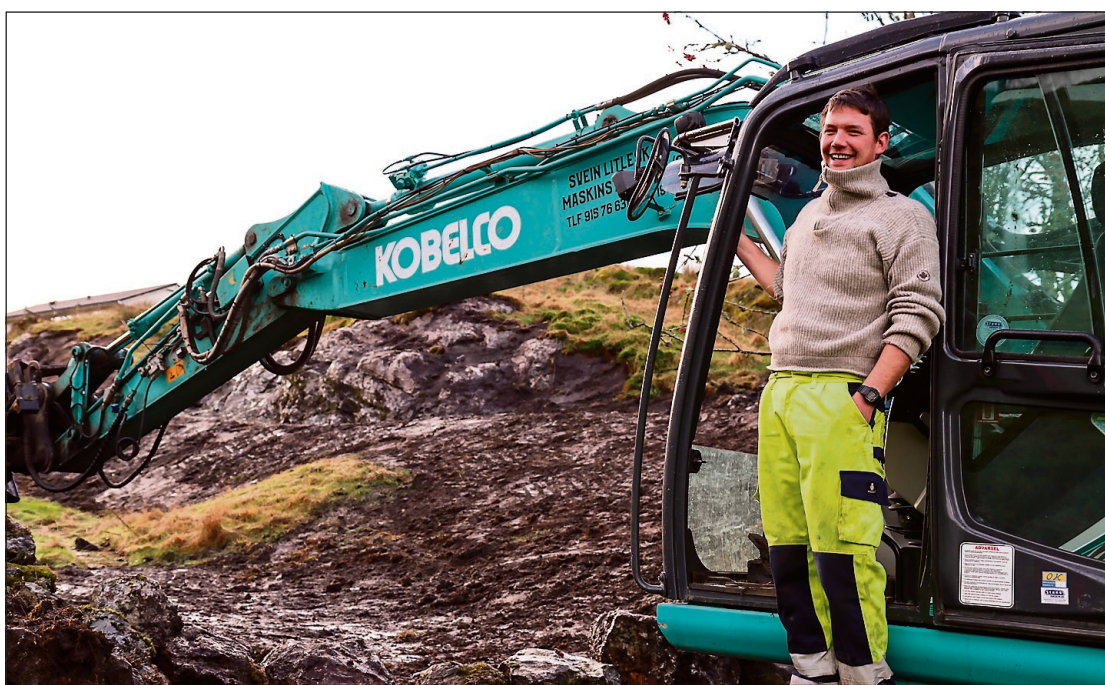
AUDMJUK: Dan Andrè Litleskare har stor respekt vegarbeidarane som tidlegare arbeide for hand. (FOTO: VEGARD FLATØY)
