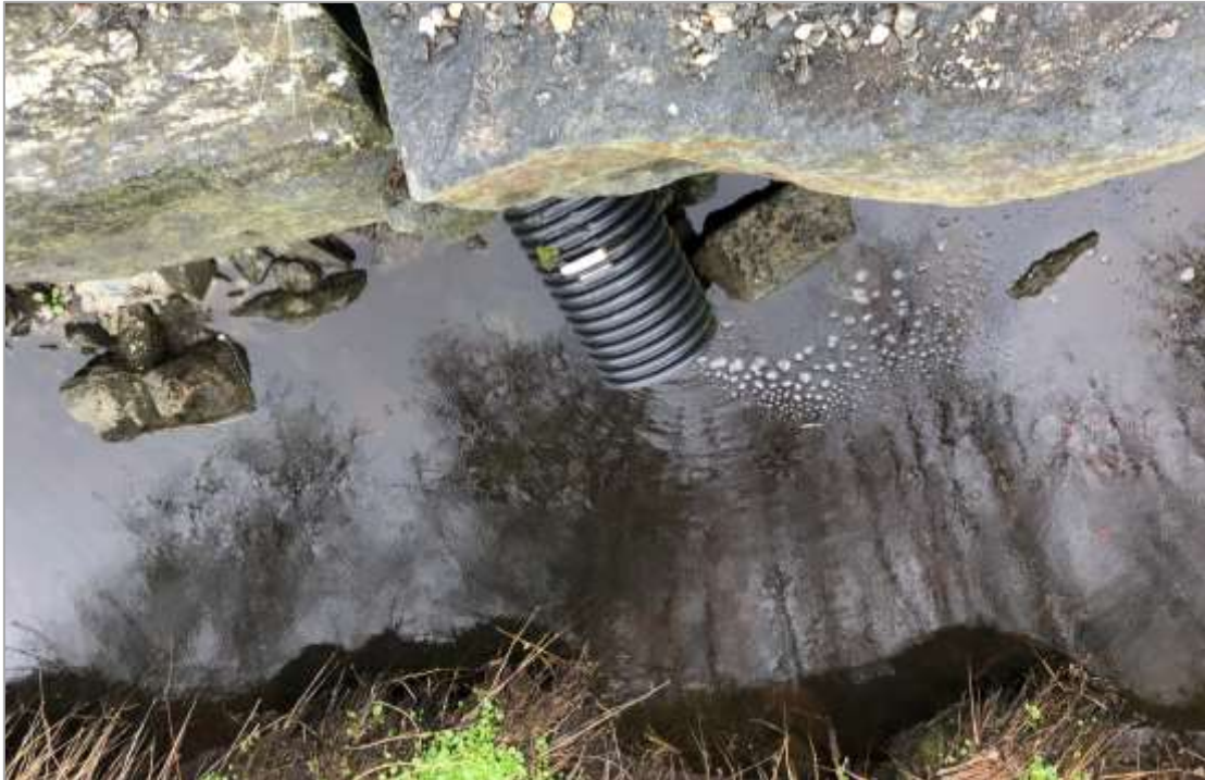
Figur 23. Eit av fleire rør med utslepp av vatn frå næringsområdet til bekken.
