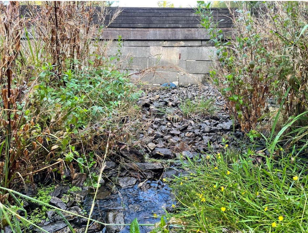
Bilde 2: Fangdam 2, 25.08.21. Nederst på bilde ser man vann som kommer ut under damkonstruksjonen.
