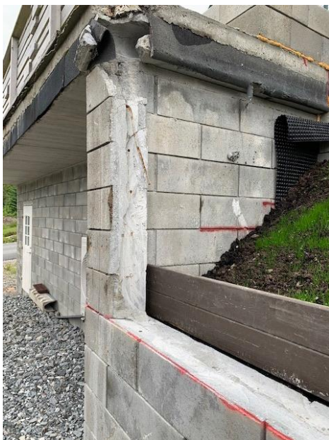
Bilde 2 som viser deler av gjenstående ulovlig mur. Hvor i rammeløyver er det dokumentasjon på at denne ulovlige muren kan stå igjen?
