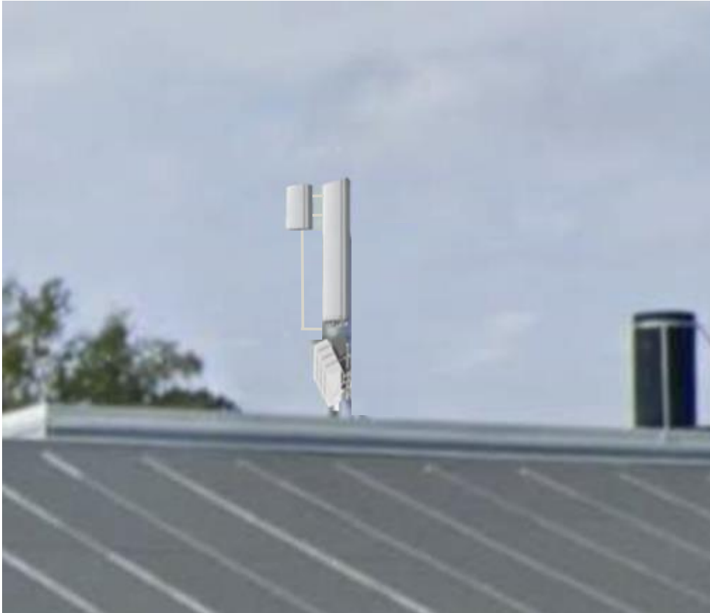
Figur 6: Sektor B2 Nytt gravitasjonsfeste med 2 antenner og RRU`r.
