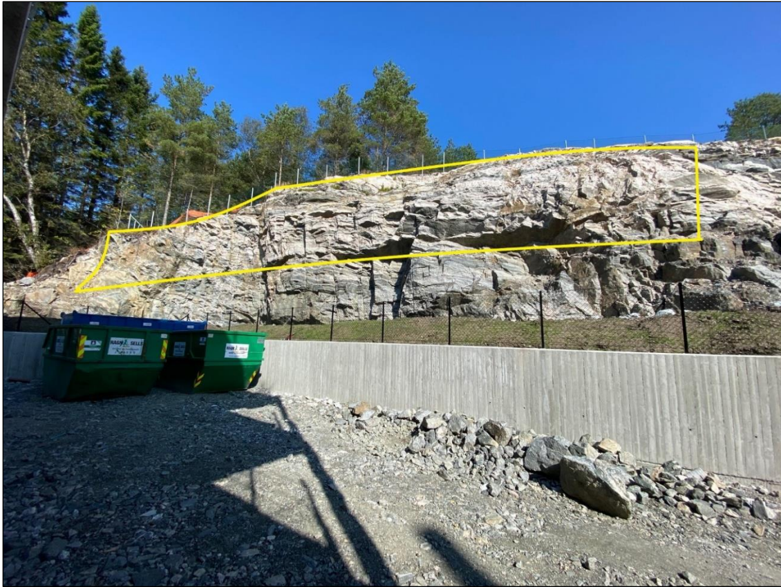
Figur 8: Anvist plassering av steinsprangnett i skjæring bak blokk A. Foto tilsendt fra oppdragsgiver.
