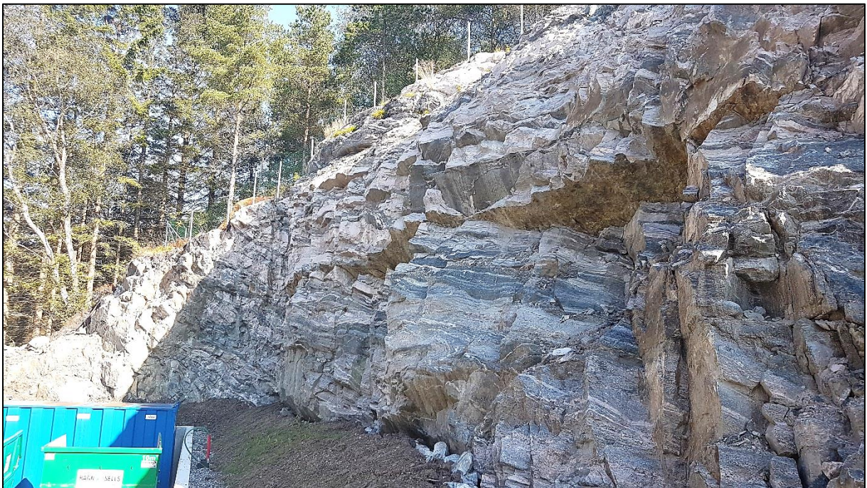
Figur 4: Skjæring bak blokk A. Enkelte overheng og sprekkeavløste stein og blokker. Foto: SGC
