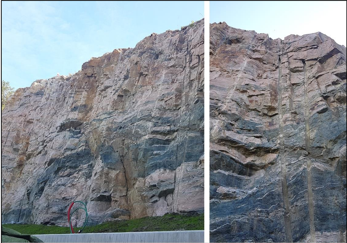
Figur 5: Skjæring mellom boligblokk B og C. Enkelte mindre overheng og mulige sprekkeavløste stein og blokker. Foto: SGC
