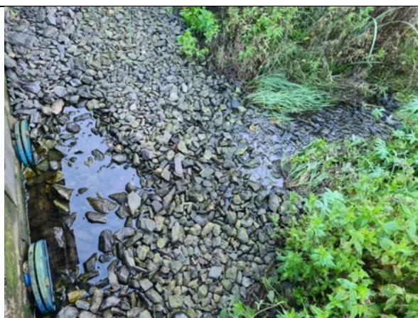
Bilde fangdam 2 ved siden av demning. Viser at vannet kommer ut under.
