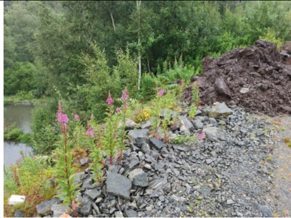
Bilde viser pågående arbeider på Mjåtveit Næringspark. Fangdam 1 kan ses på venstre side. Nylig flyttet/lagret masser vises på høyre side.
