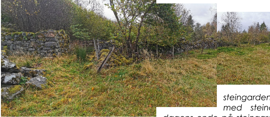
Fig. 1. Til venstre ser vi grunnmurane til gardfjøsene som ikkje skal rørast. For å kome fram med traktor, må difor muren til høgre for fjøsen flyttast ein knapp meter.
