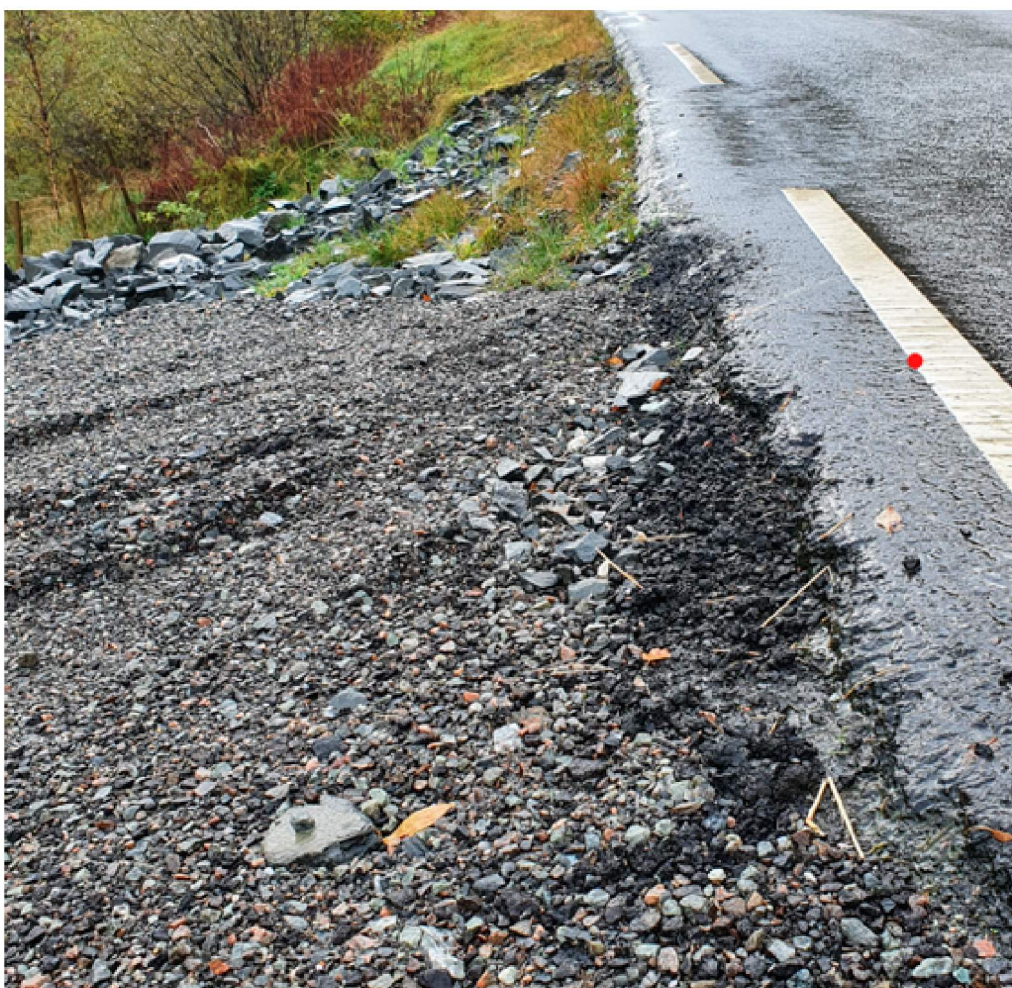
Bilete: Dårlig påkobling til fylkesvegen øydelegg asfaltkant.
