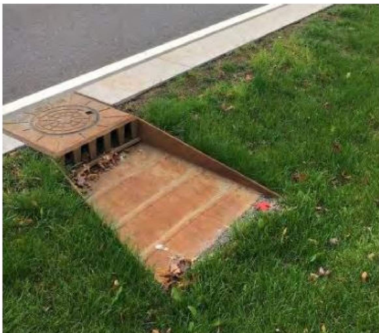
Bilde 1: Kjeftsluk som overfører vegvann til regnbed.
