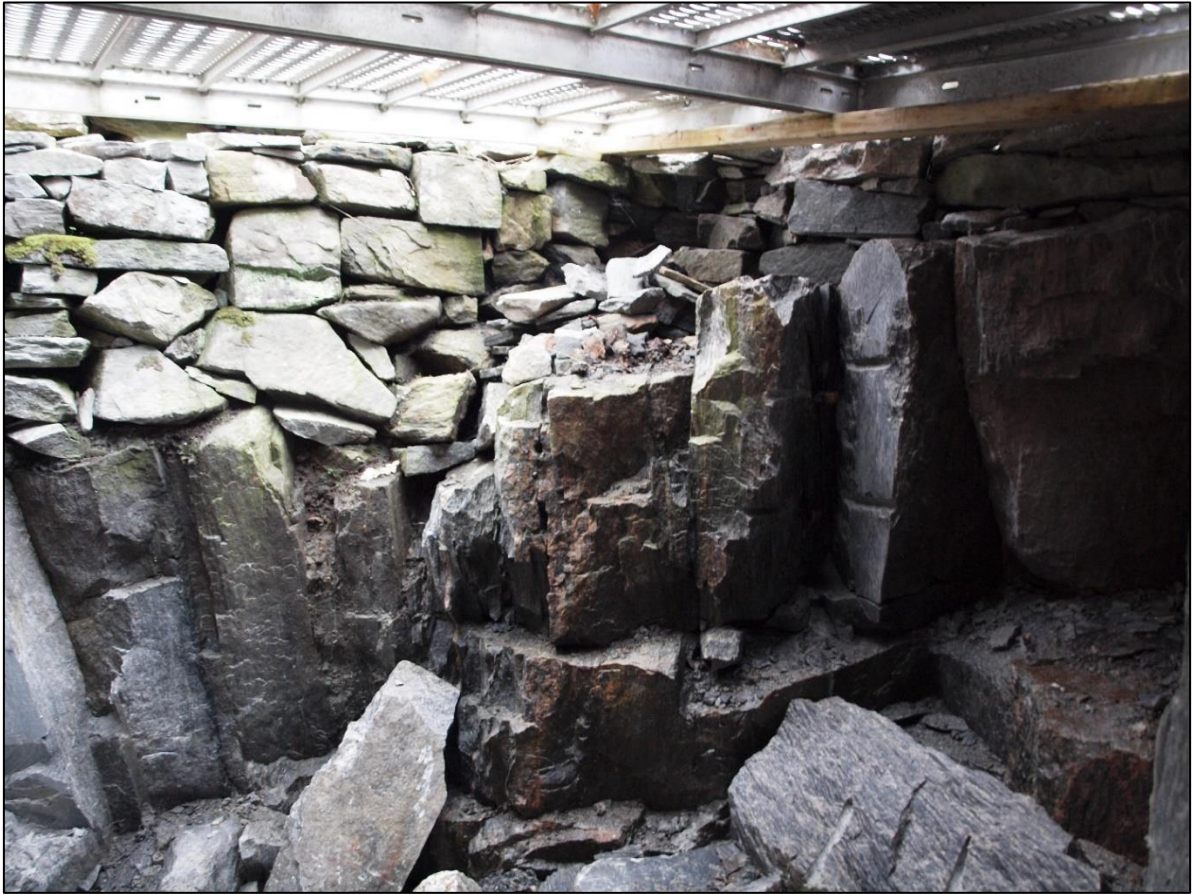
Figur 1-5. Tørrsteinmuren sett fra nabonaust. Muren hviler på berggrunn som har blitt fjernet.
