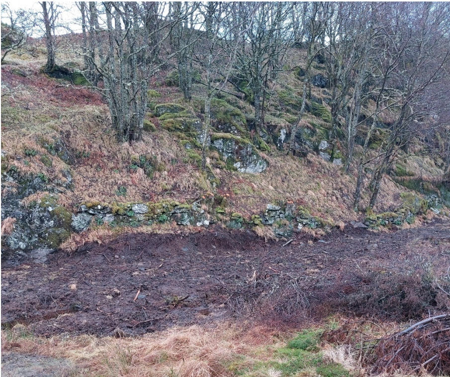
Bilete frå synfaring: Deler av muren er rast ned
