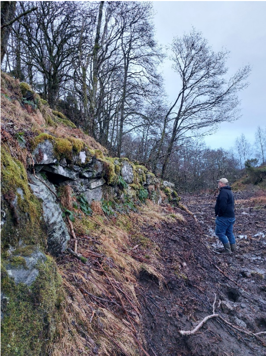
Bilete frå synfaring: Muren ligg eit stykke opp i bakken
