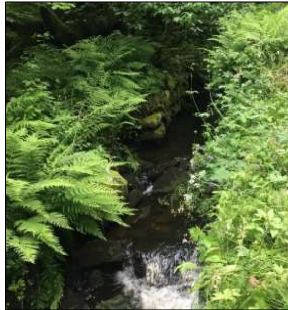
Figur 68: Steinsett parti av bekk er vanskeleg å sjå grunna attgroing.
