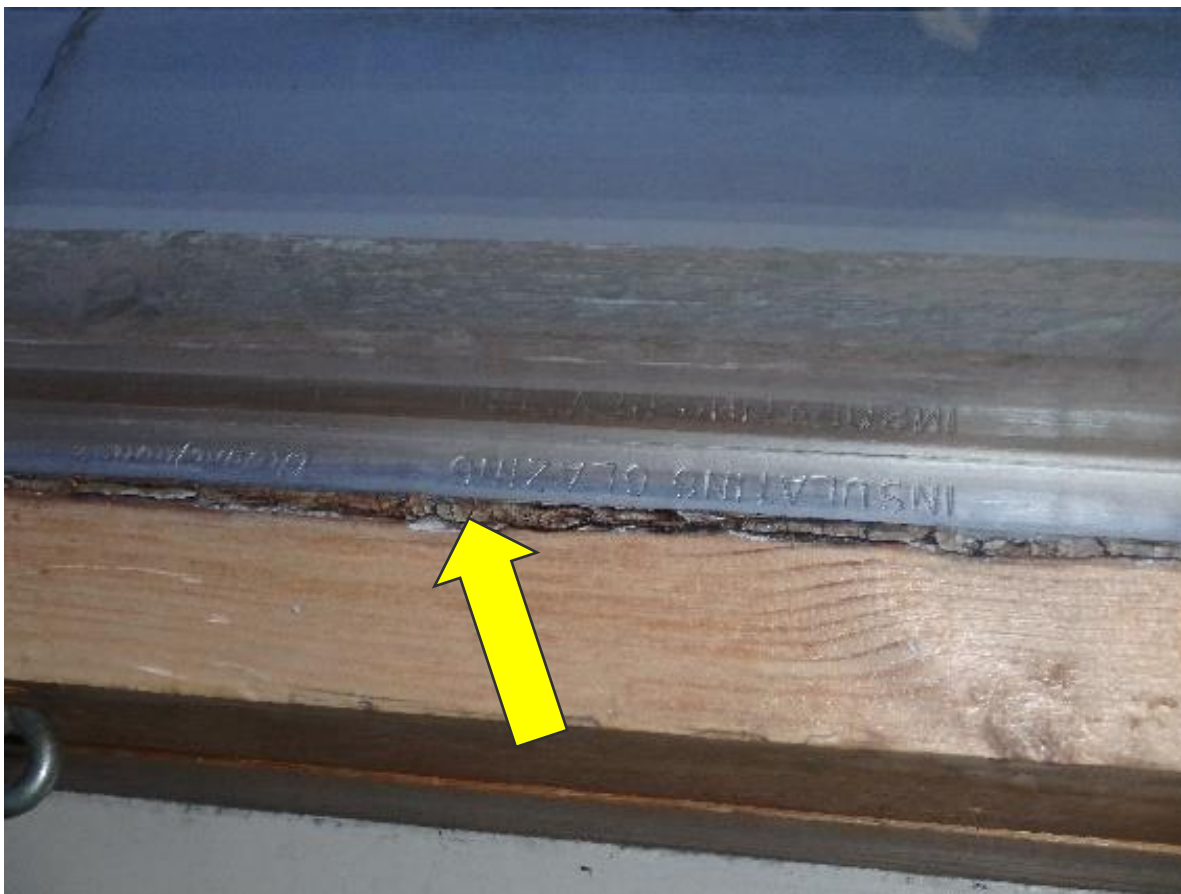
Figur 1 Nærbilde av asbestholdig vinduskitt
