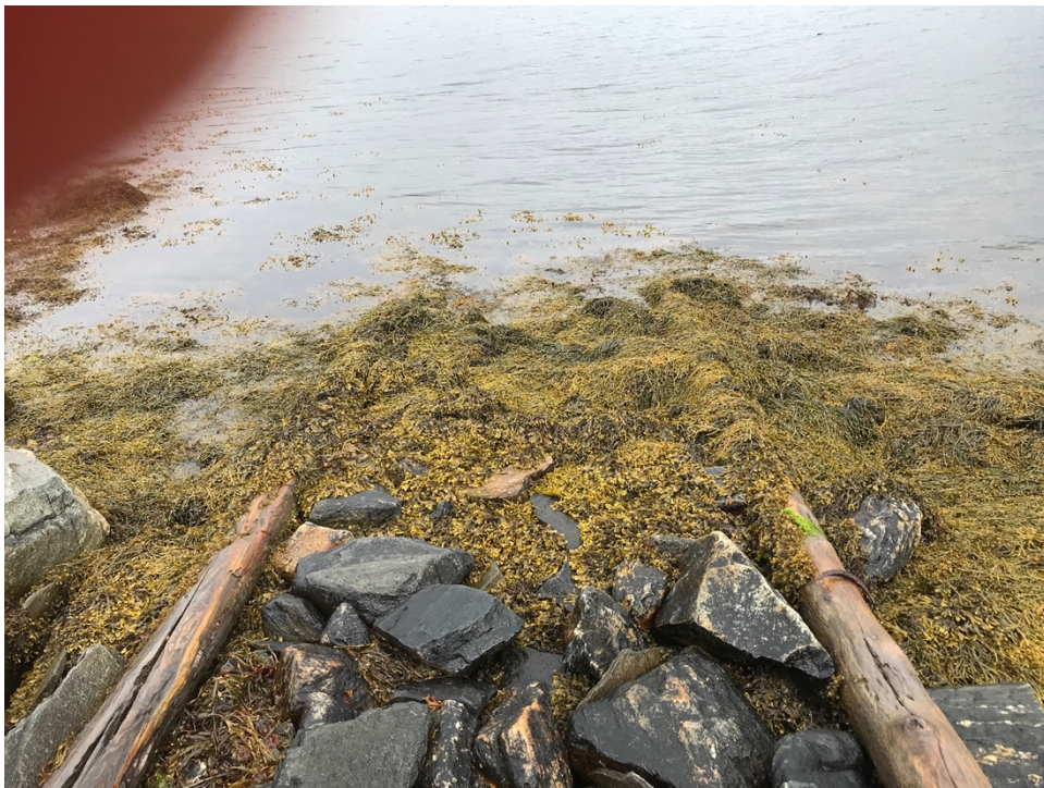
Bilde nr. 3. 4 stk.rør (slinger) ligger tvers over enden av slippen og er til hinder ved utsetting/opptrekk av båt.
