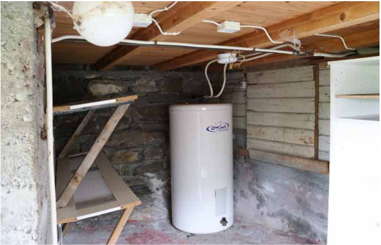
I kjellaren ser ein både gråsteinsmur og seinare betongmur – som truleg er frå 1967. På bildet over og under ser ein at deler av opphøvelg bjelkelag og golvbord er skifta ut – truleg også dette gjort i 1967.
