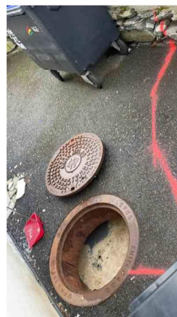
_Mot fett utskiller_S1_06072023_082120_006.jpeg, 00:01:55, 20.60m Inspeksjon fullført / Avsluttet i mini kum open profil
