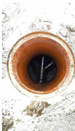
_Mot fett utskiller_S1_06072023_082120_003.jpeg, 00:00:00, 0.00m Start inspeksjon, 0%
