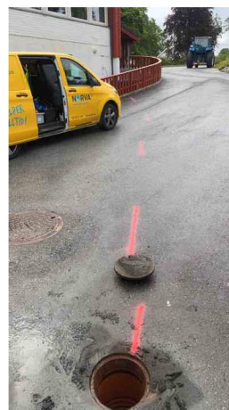
_Mot fett utskiller_S1_06072023_082120_004.jpeg, 00:00:00, 0.00m Start inspeksjon, 0%
