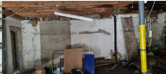
Bilde 11 – Gamle lysarmaturer.
