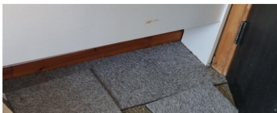
Bilde 6 – Vinylgulvbelegg på kontoret inneholder mellomkjedete klorerte parafiner over grenseverdi for farlig avfall.
