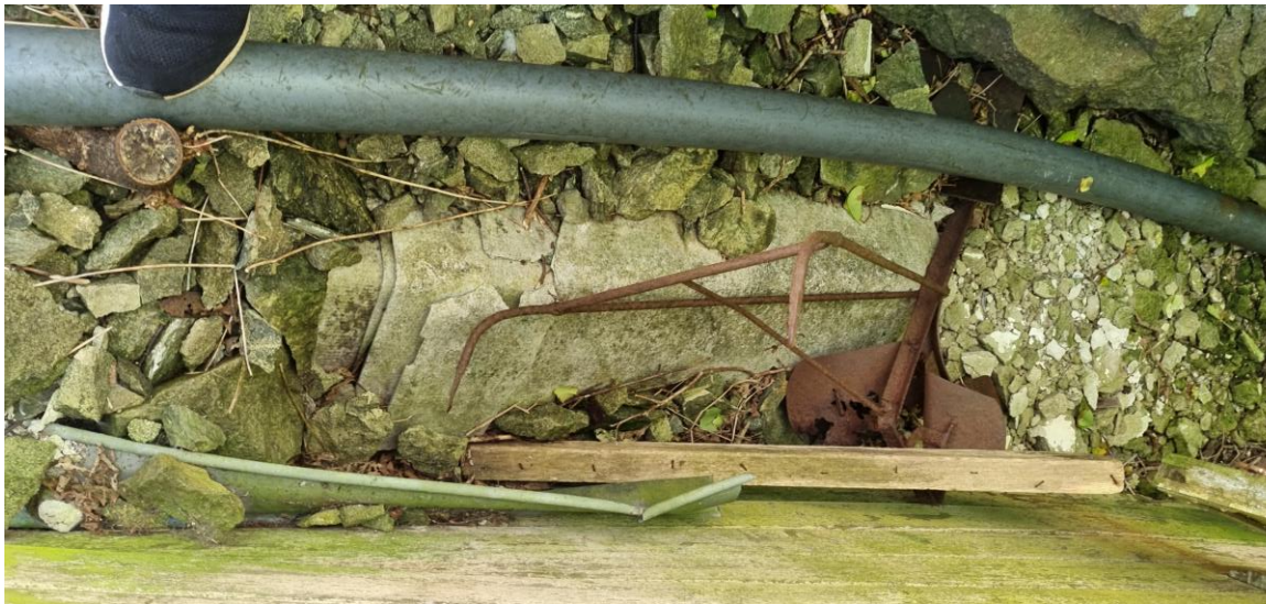
Bilde 3 - Eternitplater ved nordvest-fasade.
