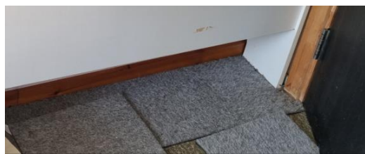
Bilde 5 – Gulvbelegg på kontoret i 2. etg. er uten PCB men inneholder store konsentrasjoner MCCP.
