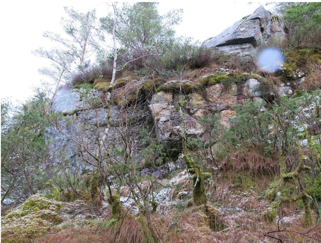
Bilde 4. Potensielt løseområde for steinsprang, nordøst for planområdet. Se faresonekart for potensielt utløpsområde. Bilde tatt mot øst.
