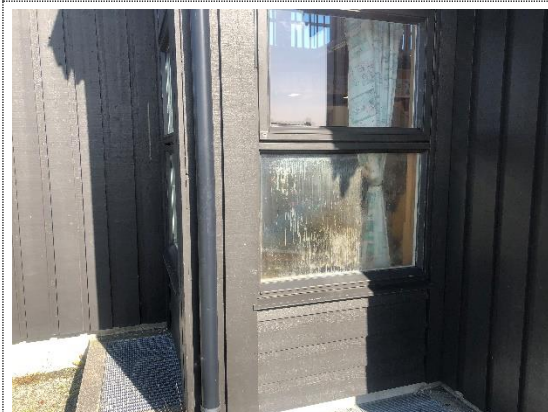
Bilde nr. 234.02 Utv. vinduer, dører, porter Det ble registrert noen vinduer og dører som ikke ble skiftet under rehabiliteringen.
