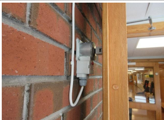
542.03 Dørmagnet på brannskilledør
