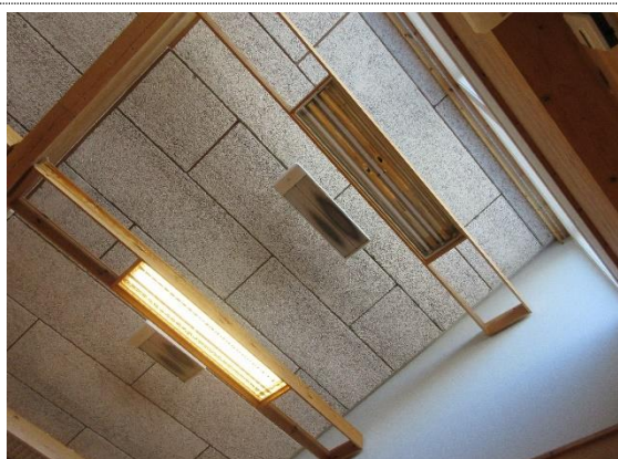
450.02 Takvarmepaneller i klasserom
