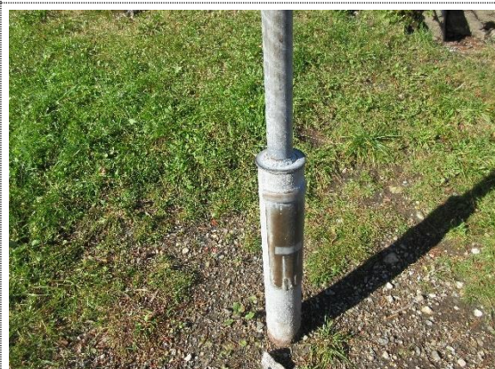
740.05 Armaturstolpe med preg av alder
