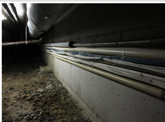
410.04 Føringsveier i kultvert under bygget
