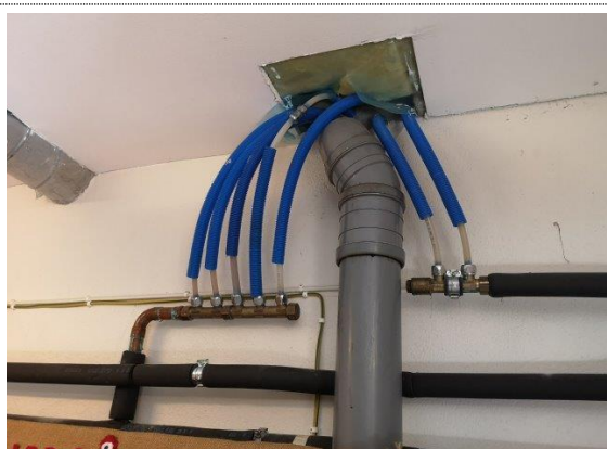
Bilde nr. 310.03 Enkelte nyere fremlegg i rør i rør (E-blokk)
