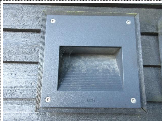
740.03 Innfelt veggarmatur ved inngangsparti
