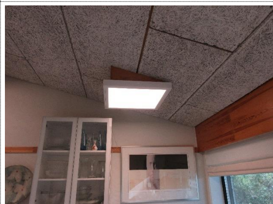
440.02 Nyere type utenpåliggende LED armaturer
