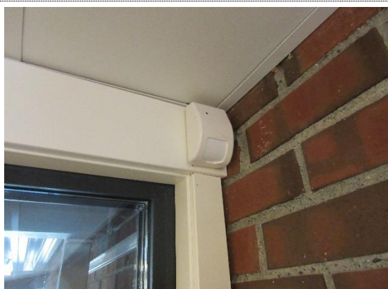
540.01 PIR detektor innbruddsalarm
