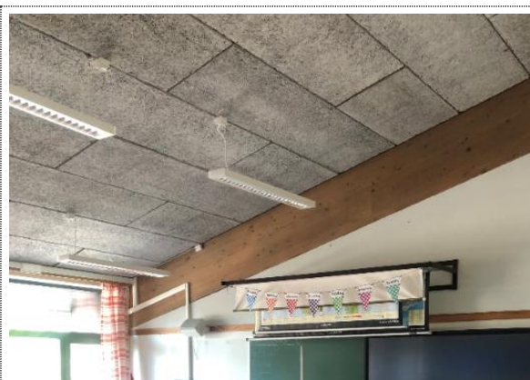
Bilde nr. 256.02 Himlinger Faste himlinger av eldre årgang. Må kontrolleres i forhold til asbest.
