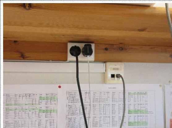
410.03 Anlegg supplert med åpen installasjon
