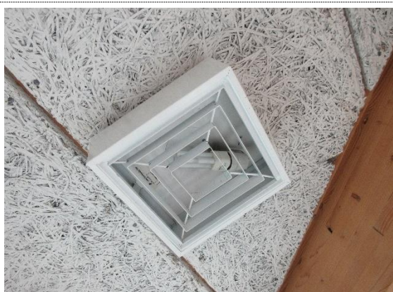
440.03 Eldre armaturtype med kompaktlysrør
