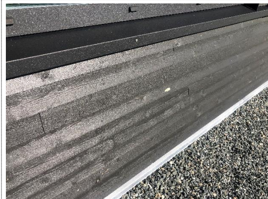
Bilde nr. 230.02 Yttervegger Småskade i maling.
