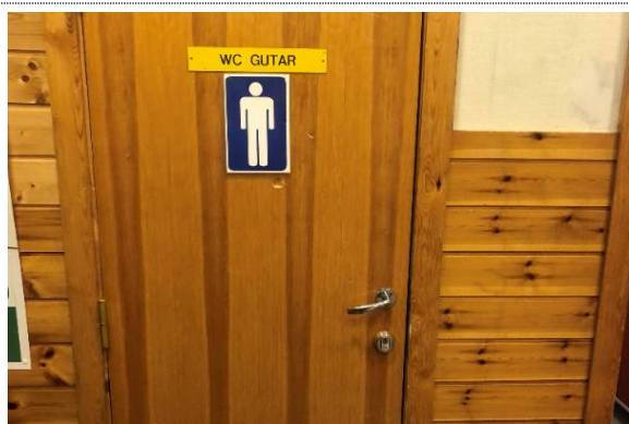
Bilde nr. 244.02 Det er registrert noen dører med sår og skader.
