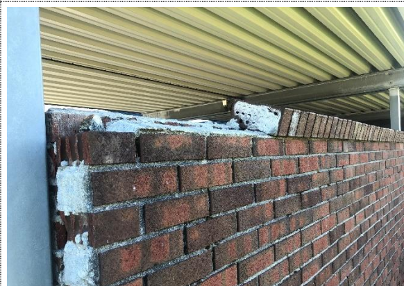
Bilde nr. 721.01 Støttemurer og andre murer Mur under leskur bør repareres.
