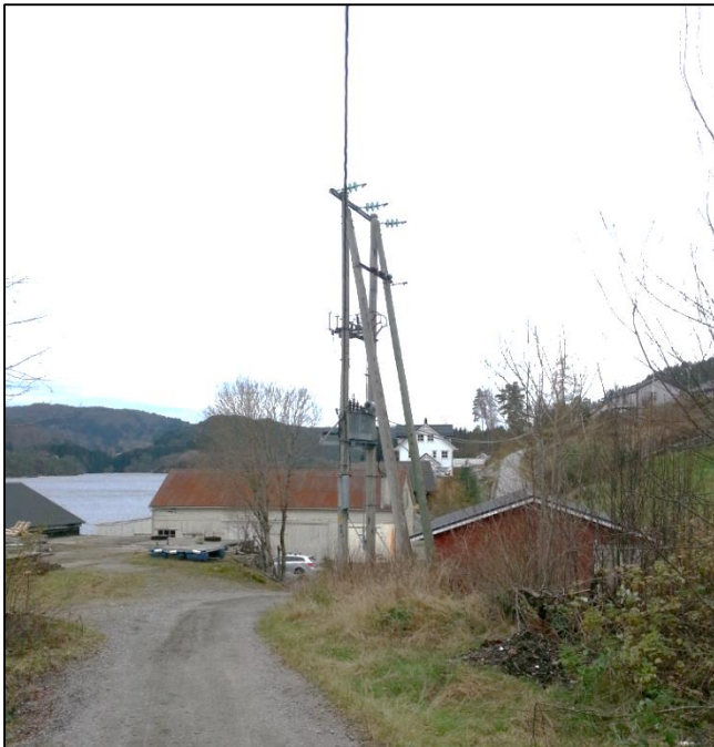
Figur 20: Mastetrafo i området.
