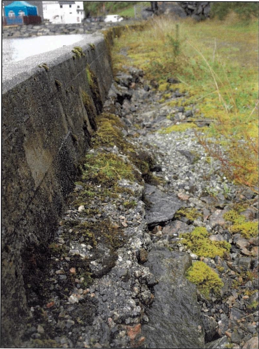
Fig 20. Betongkant inkludert såle har seget..
