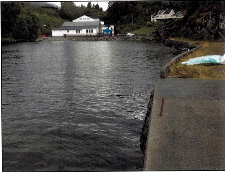
Fig 19. Støpekant mot sjø har sig.
