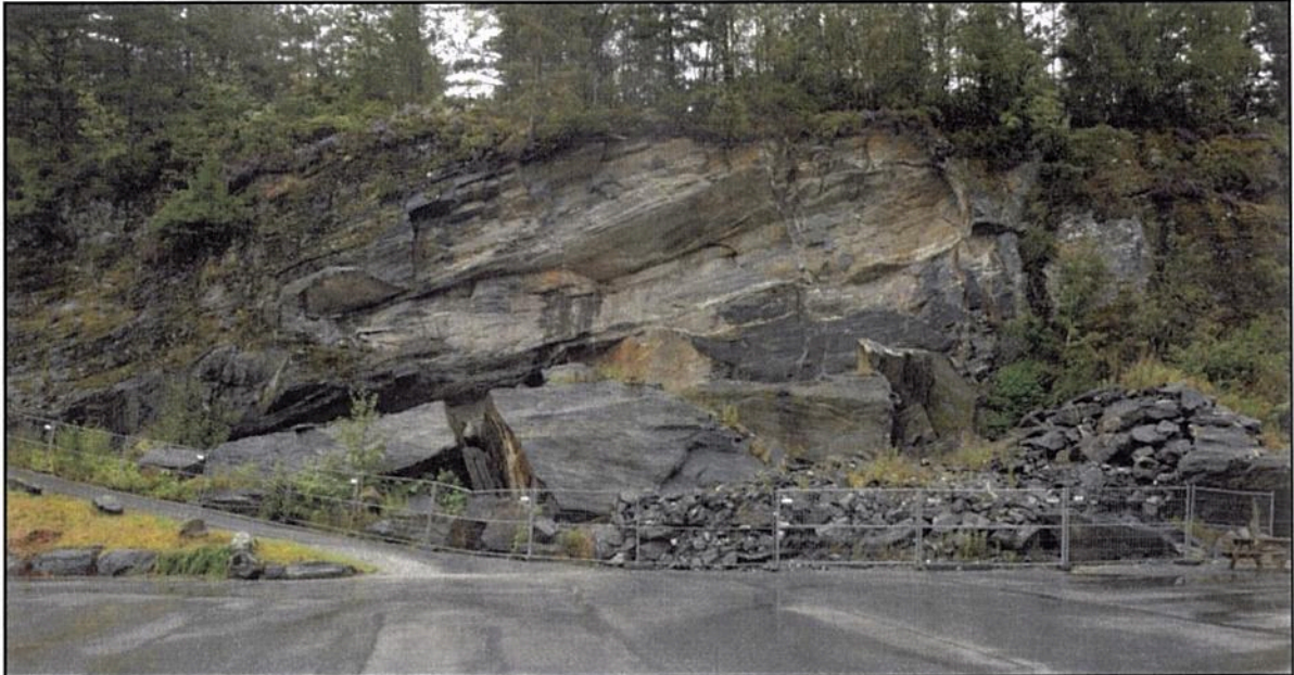
Fig 8. Ut-rast skrent med nedfalt materiale.
