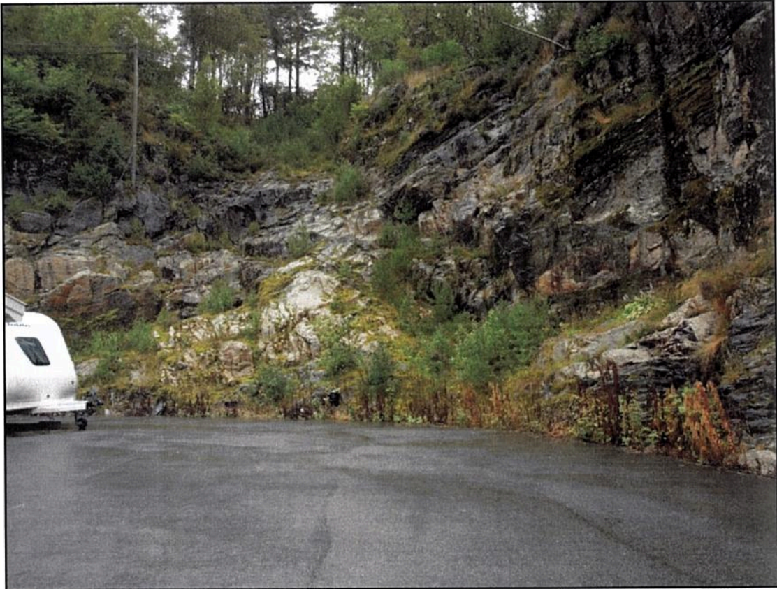
Fig 14. I oppkjørsel til bolighus nordøst for kai-anlegg er det oppsprukket granittisk gneis.
