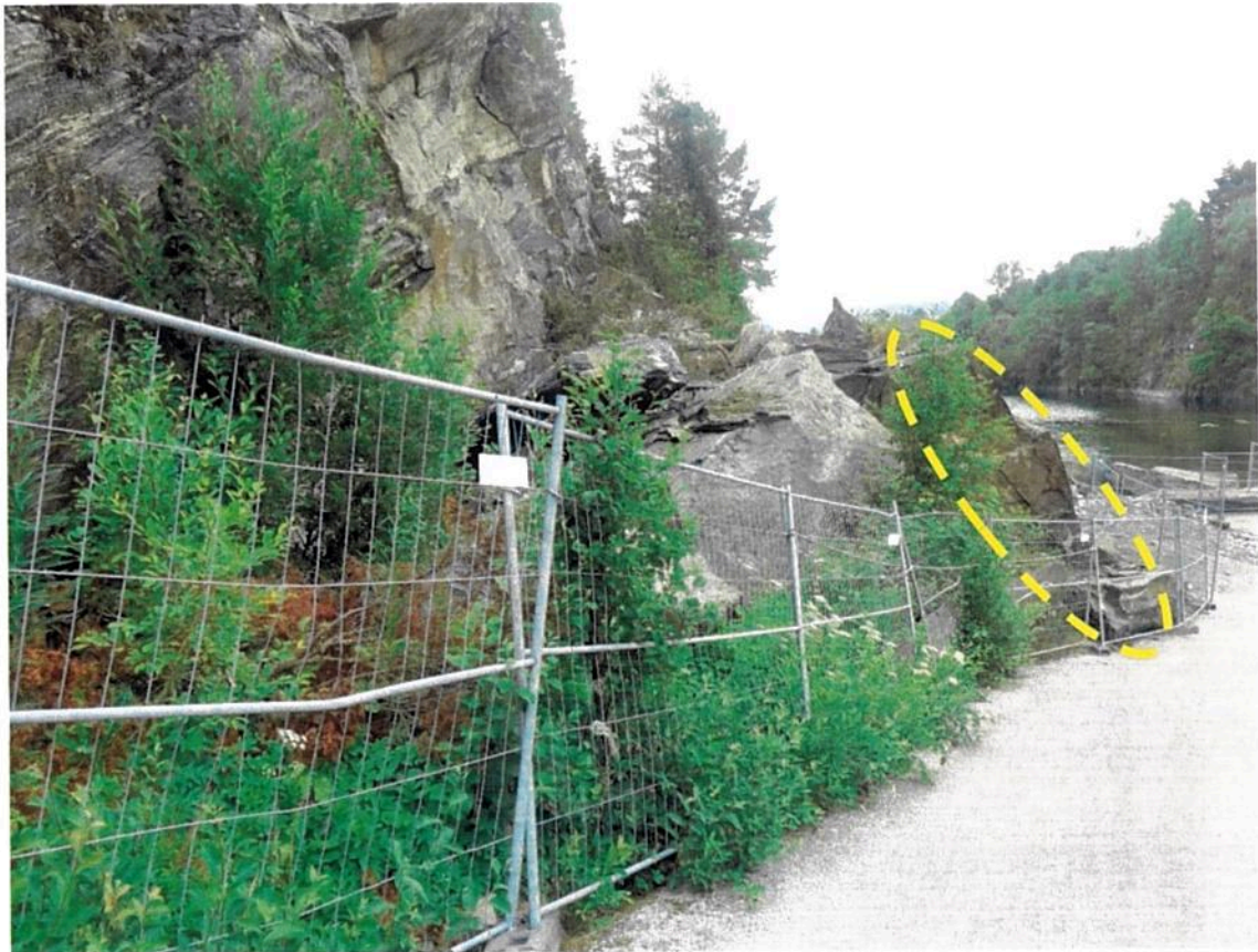
Bilde 3. Gul sirkel viser hvilke bergblokker som kan fjernes etter at sikringsarbeidet er utført.
