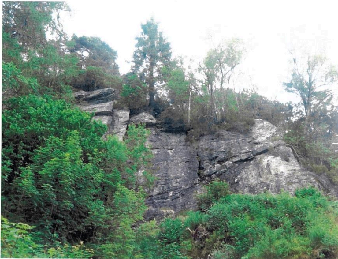
Bilde 6. Dette bergpartiet bør sikres med bolter og bergbånd for å unngå nedfall mot ullvarefabrikken. Geolog bør være med å anvisne sikringen fra lift.
