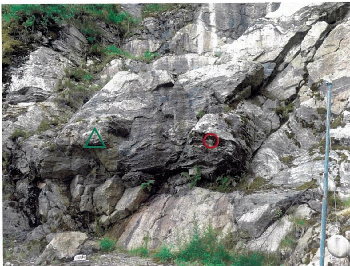
Bilde 4. Avløste bergblokker som bør sikres for å unngå nedfall.
