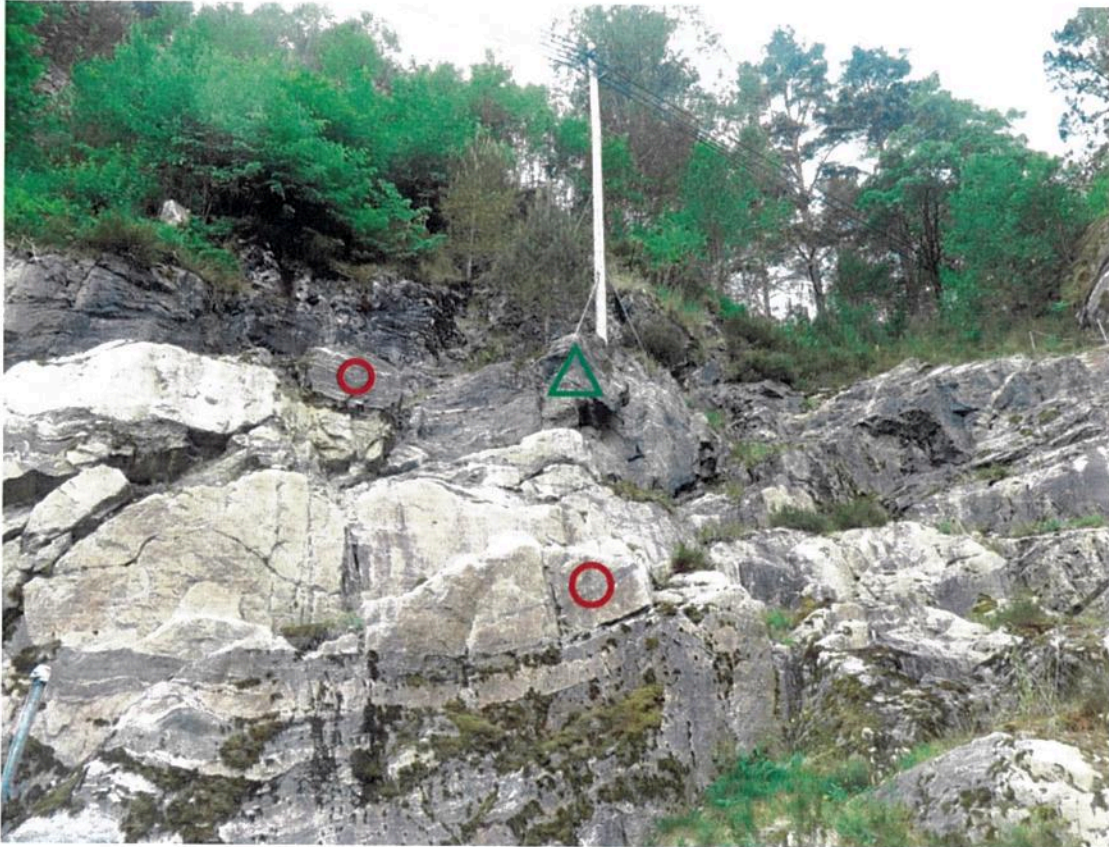
Bilde 5. Avløste bergblokker som bør sikres for å unngå nedfall.
