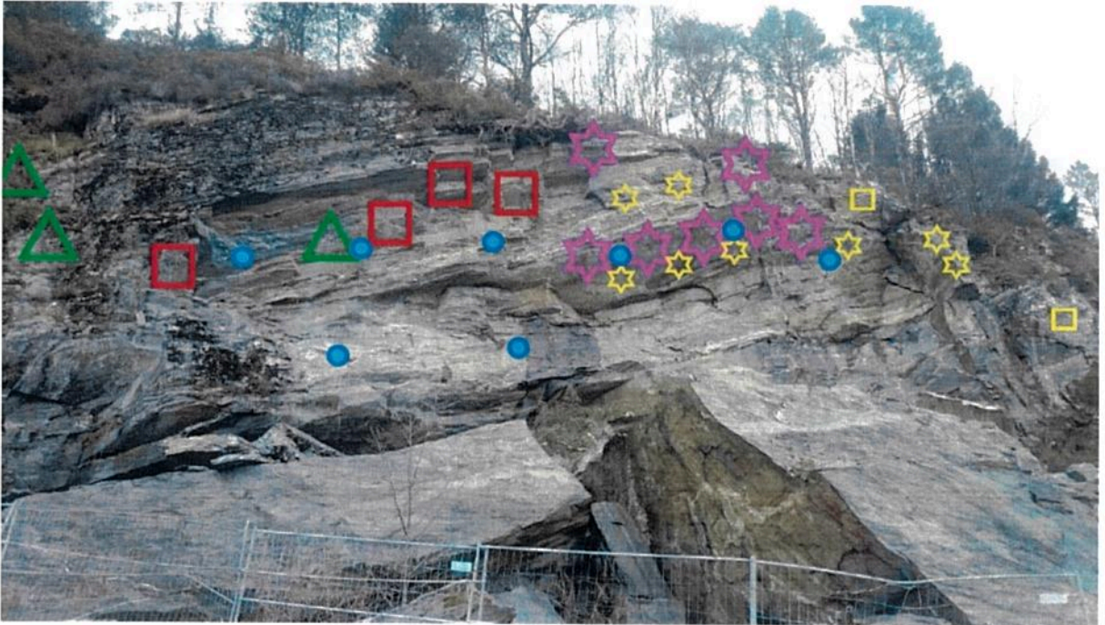
Bilde 1. Berget skal sikres som anvist med 3,0-6,0 m lange bolter og minimum 3,0 m dype/lange og 2" brede drenshull som bores gjennom vannførende sleppe. Boltene skal bores horisontalt inn i berget. Drenshull skal bores 15° på stigning. Tegnforklaring nederst i fotobilag viser dimensjoner på boltene i forhold til de ulike symbolene på bildet. Gul farge viser supplerende bolter hvor det ikke er boret hull.
