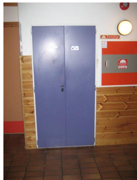
Bilde 4: El-tavle plassert i rømningsvei
