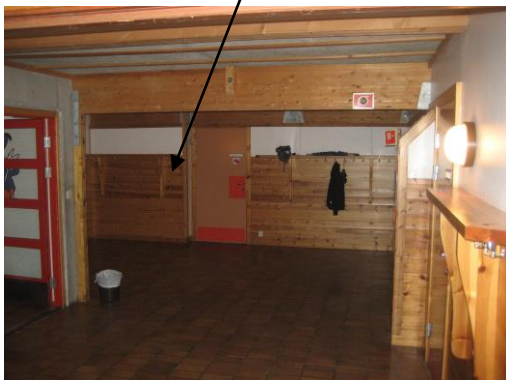
Bilde 2: Trekledning i rømningsvei
