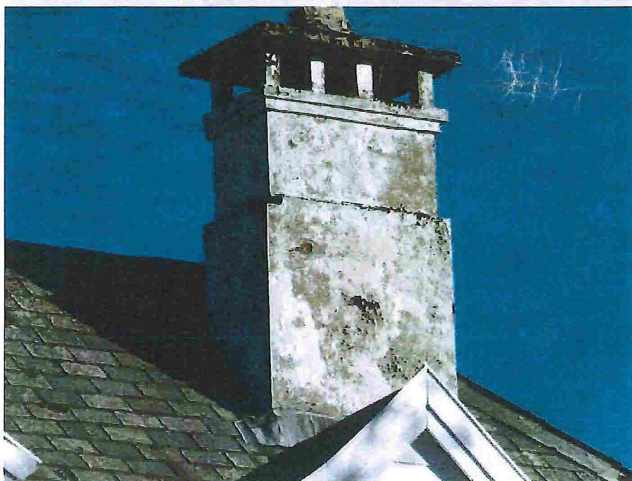
Pipe over tak med tilsynelatende lekkasje.
