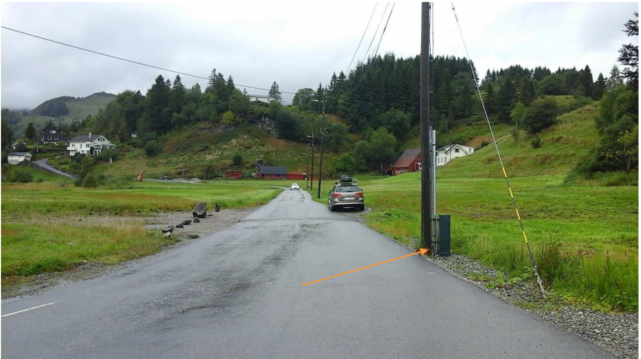
Fordelerskap langs vei
