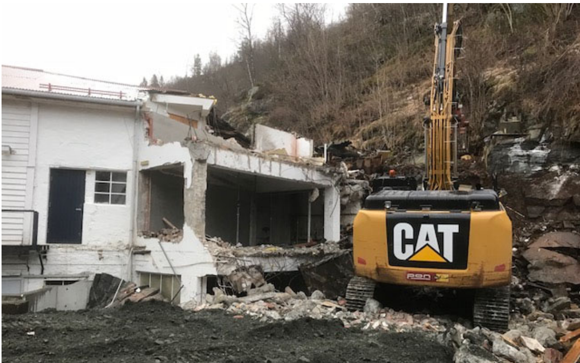
Liten del av kjellar, 1. etasje og loftet av ishuset står igjen.
