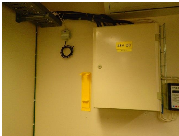
Bilde 10: 48 V fordelerskap 2. etasje
