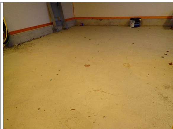
Bilde 1: Malt betonggulv i 1. etasje
