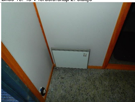
Bilde 12: Panelovn 2. etasje.
