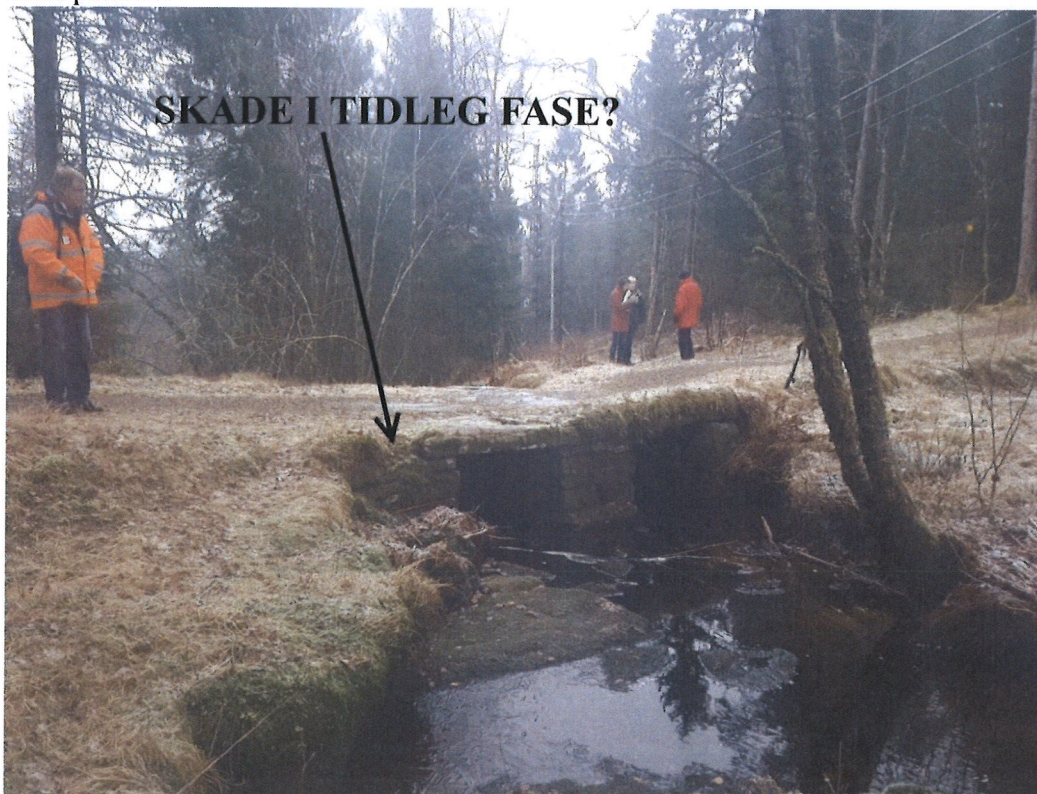
Fig. 8. Biletet syner det som truleg er ein setningsskade i tidleg fase.
