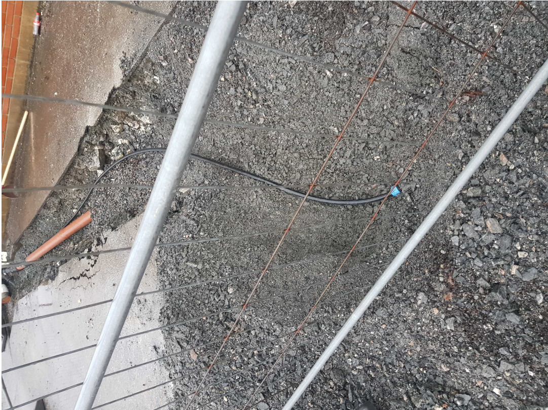
Skjema: "7-320DR Kontrollskjema for sanitæranlegg i buening" Filnavn: 20180209_091017.jpg
