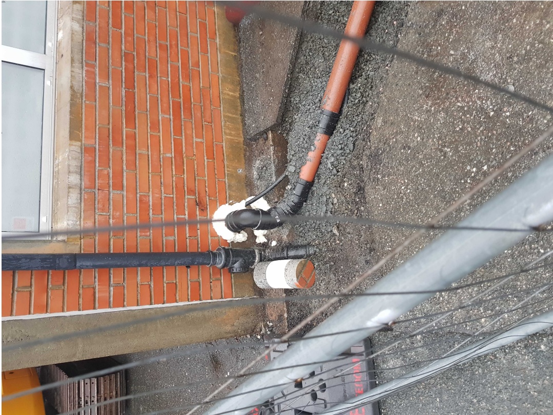
Skjema: "7-320DR Kontrollskjema for sanitæranlegg i buening" Filnavn: 20180209_091029.jpg
