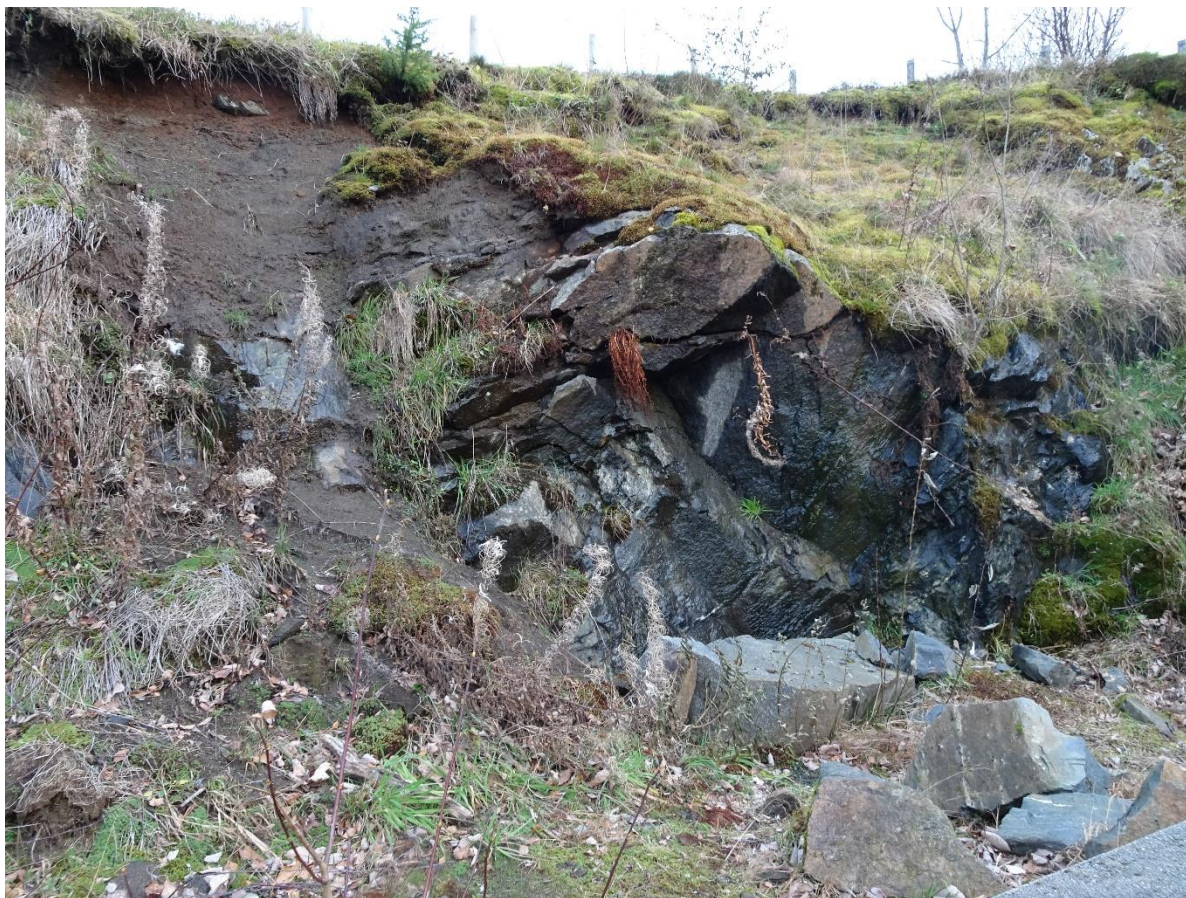
Figur 6. Skjæring ved kunstgressbanen. Berget er oppsprukket og det har falt ned en del stein.
