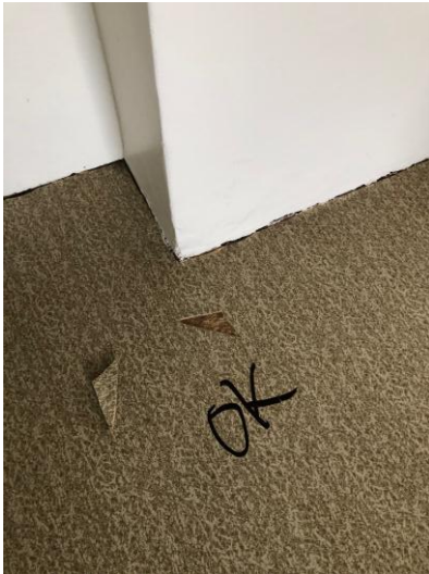
Gulvbelegg som er restavfall
