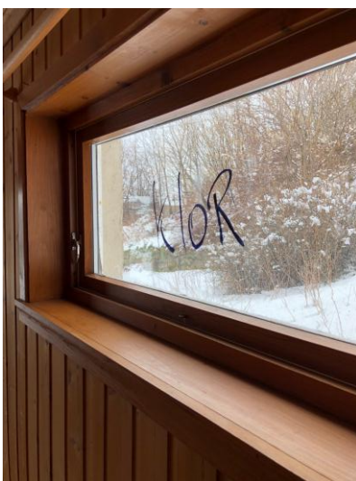
Vinduer merket klorparafiner
