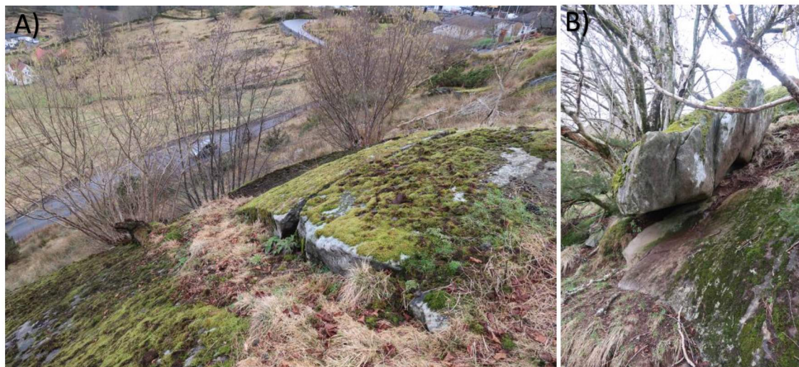
Figur 7. Blokker over Eidevegen. A) Vurdert til å ligge stabilt. B) Blokk som kan utgjøre skredfare.
