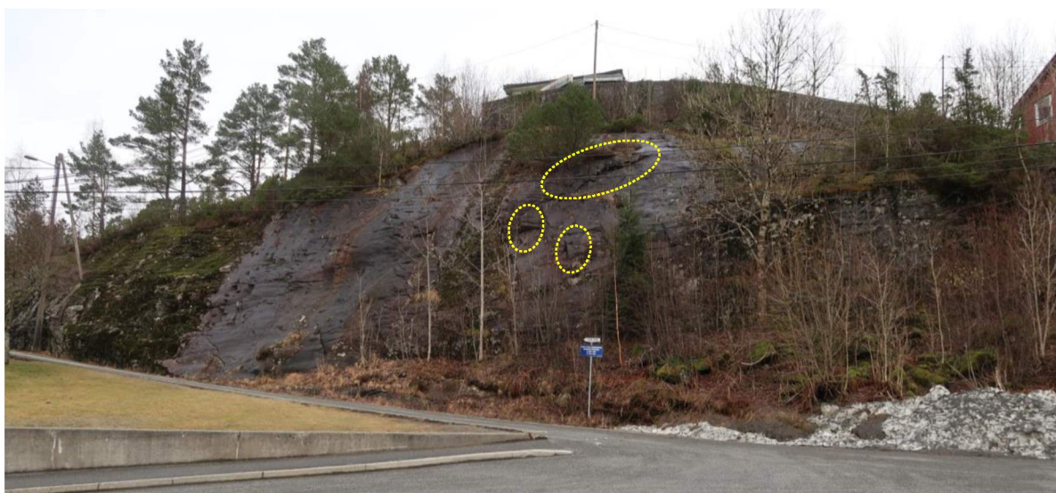
Figur 12. Glattskurt bergparti øst for ungdomsskolen. Flak/blokker som utgjør skredfare er markert med gult.
