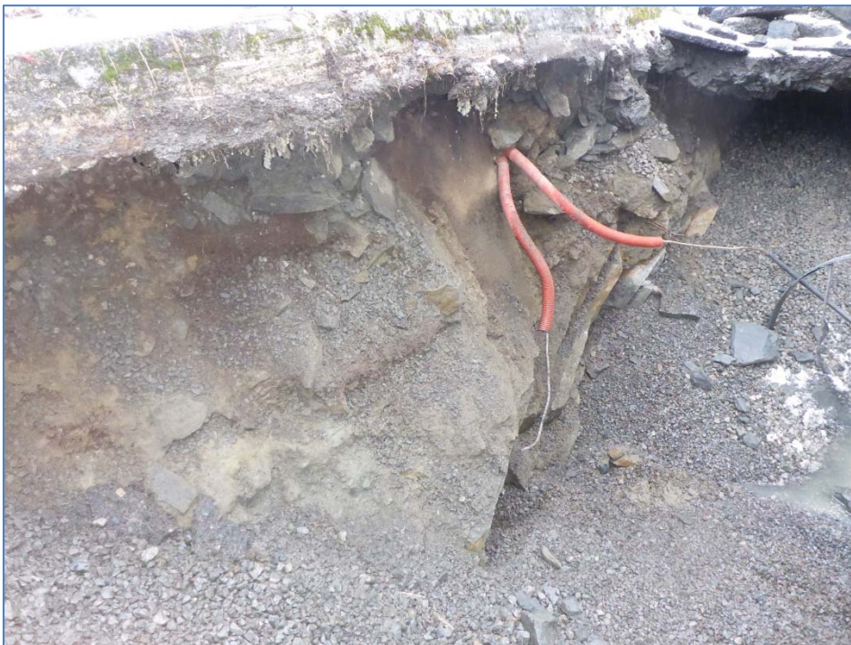
Figur 7 Det ble registrert berg i siden av tankropa mot veien. Foto: Multiconsult.
