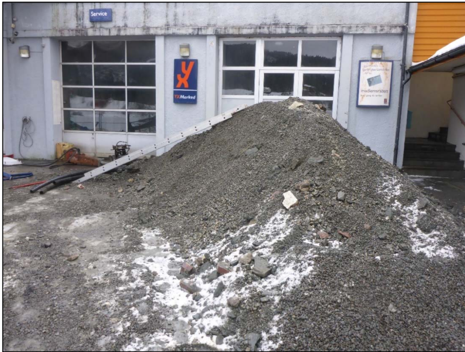
Figur 6 Oppgravde masser. Singel var benyttet som omfyllingsmasser rundt og under tankene. Foto: Multiconsult.
