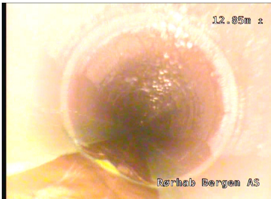
Foto: 1_1_2_07112017_195031_A.jpg 12,85m, Hindring, reduksjon i tverrsnittsareal er 5% eller mindre, 06 Kl., Andre, Deler av gul transport kappe sitter i skjøt
