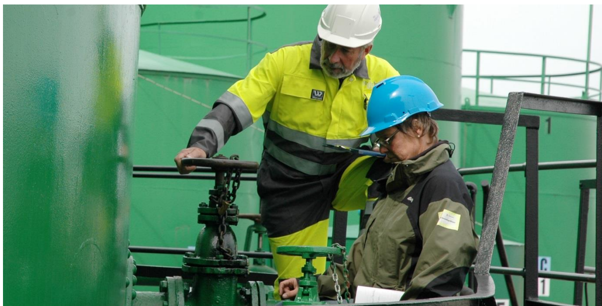
Samtidig tilsyn utført av Miljødirektoratet og DSB. Foto: Tore Kamfjord
