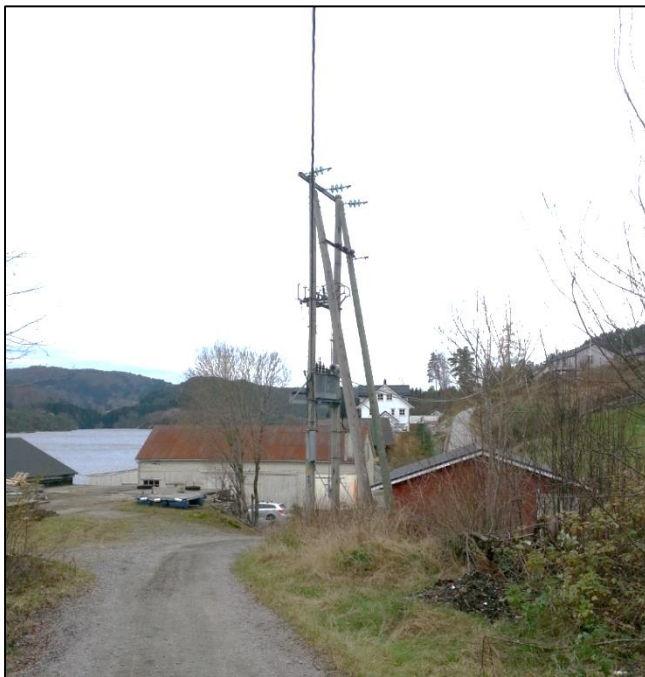
Figur 20: Mastetrafo i området.
