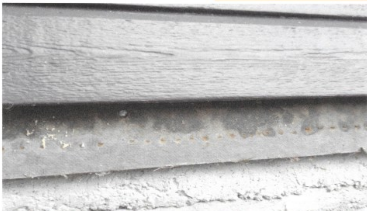
Bilde 27. Viser hvor det er registrert at det kommer vann fra baksiden av klodning. Dette må ha pågått over lengre tid.
