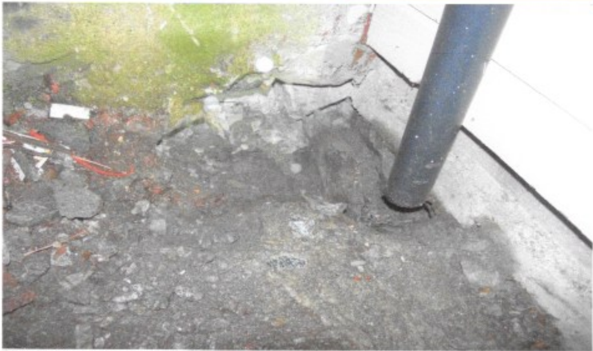
Bilde 39. Viser at takvann har vært ledet rett til terrenget.
