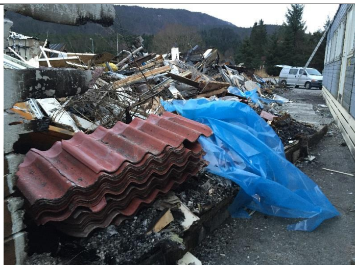
Asbest som er stablet på branntomten
