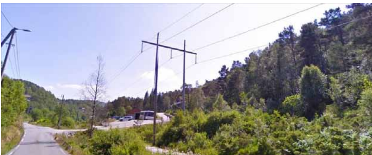
Figur 2.3. Eksempel på 132 kV kraftledning bygget på H – master av trestolper med toppline.
