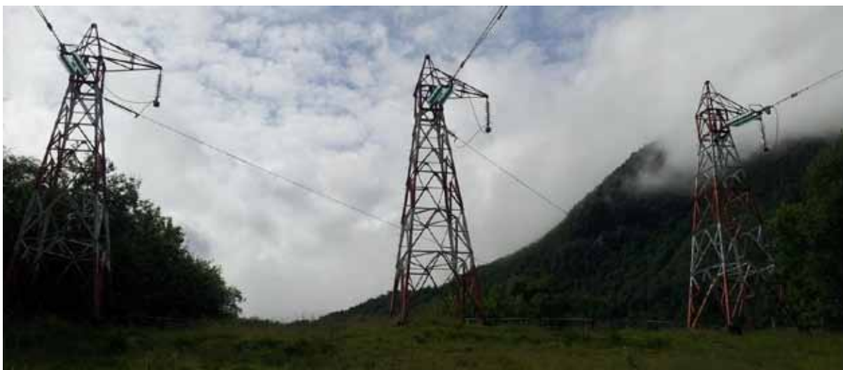
Figur 2.4. Eksempel på 132 kV fordspennmaster.
