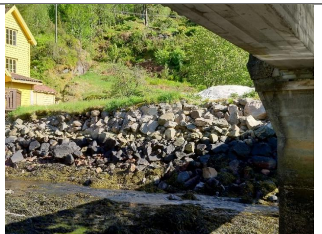
Bilde 4: Vannførselen i elven tilsvarer nå knapt nok en liten bekk. - Der elven går ut i viken (innenfor broen) er det som før var brakkvann (dominert av ferskvann), nå hovedsakelig sjøvann. Som bildet viser så er bunnen, som før var bar, nå helt dekket av tang (saltvannsvegetasjon).
