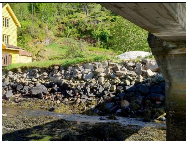
Bilde 4: Vannførselen i elven tilsvarer nå knapt nok en liten bekk. - Der elven går ut i viken (innenfor broen) er det som før var brakkvann (dominert av ferskvann), nå hovedsakelig sjøvann. Som bildet viser så er bunnen, som før var bar, nå helt dekket av tang (saltvannsvegetasjon).
