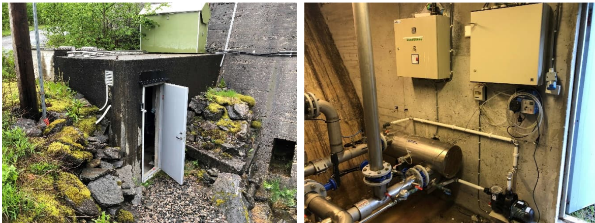
Figur 12: Vassbehandlingsanlegg og UV-aggregat for Matre vassverk
