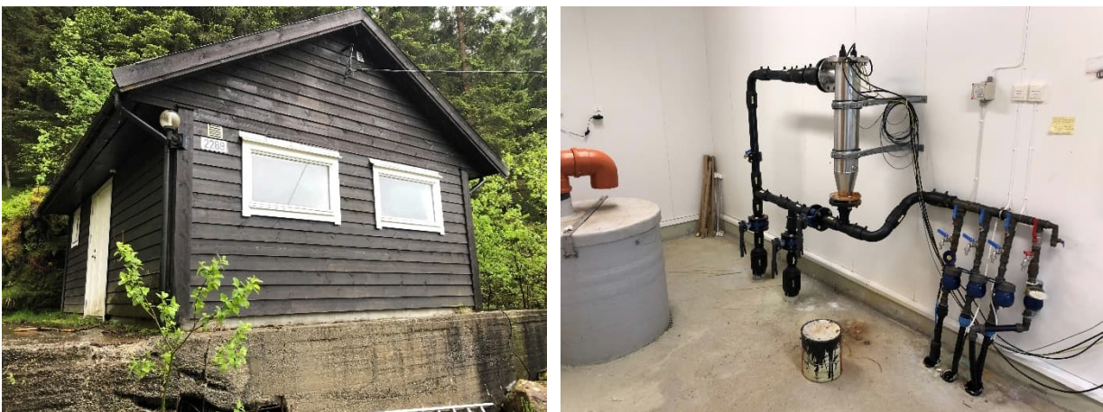
Figur 14: Vassbehandlingsanlegg på Haugsvær, utvendig og innvendig
