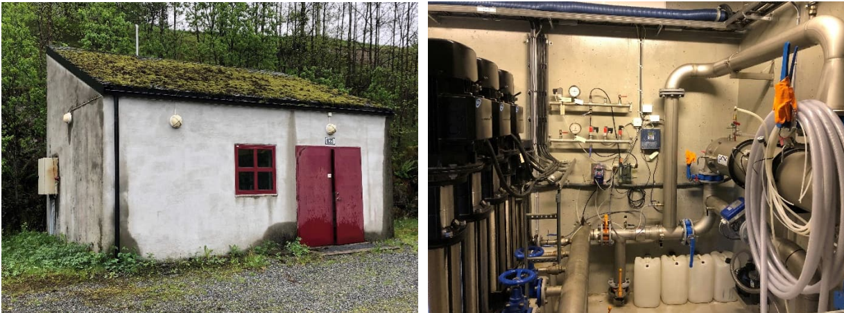
Figur 6: Andvik vassbehandlingsanlegg (bygning), samt UV-aggregat for desinfeksjon (innvendig til høgre) og pumper for trykkauking (innvendig til venstre).
