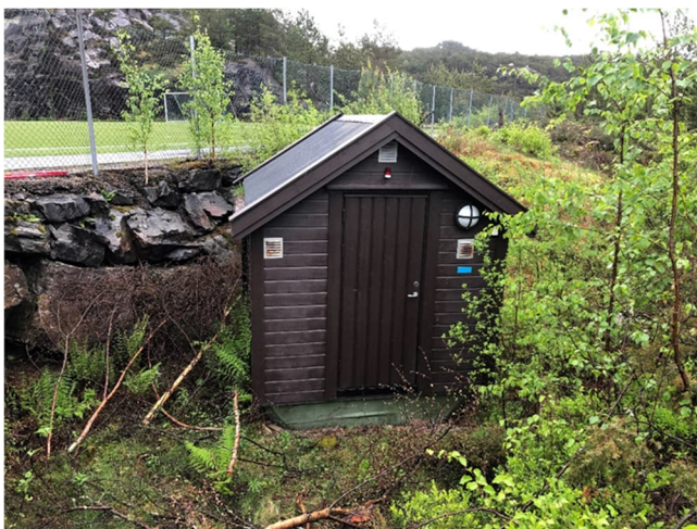
Figur 24: Avlaupspumpestasjon ved idrettsbana på Hosteland
