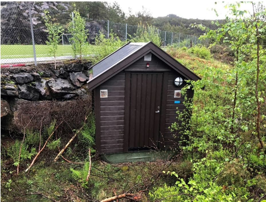
Figur 20: Eksisterande avlauspumpestasjon ved idrettsplassen på Hosteland.
