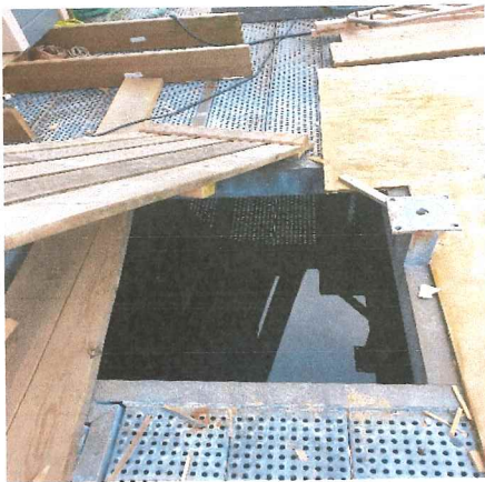
Plass for motorbrakett og tilgang til areal under overbygg.
